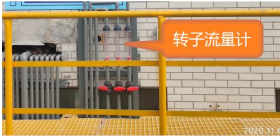
图 3-12 第一类重金属污染物废水预处理排放口流量计
